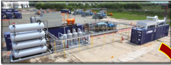
LNG liquefaction plant
